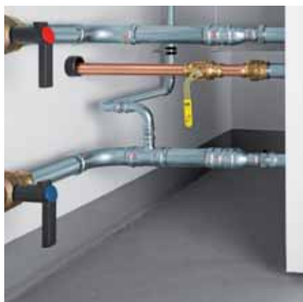
Collegamento di una caldaia: mandata e ritorno con Prestabo e rubinetti a sfera Easytop. Collegamento del gas con Profipress G.
